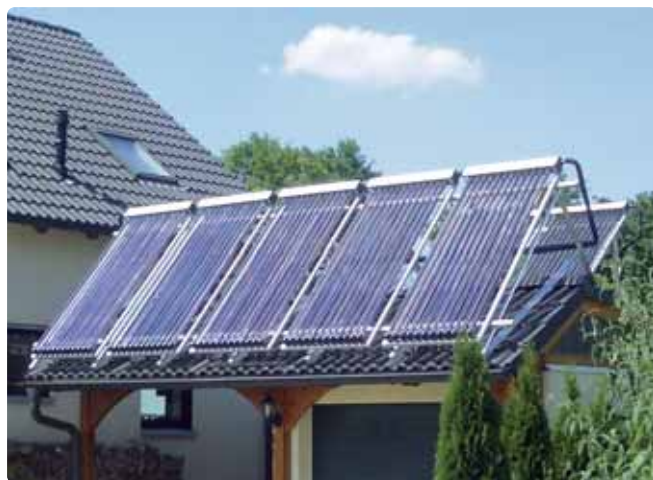
Abb.: Vakuumröhrenkollektoren VRK 12 als Flachdachmontage
