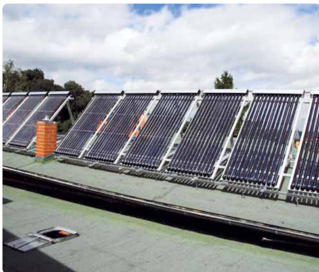
Thermische Solarflachdachanlage Privathaus in Eberswalde.
