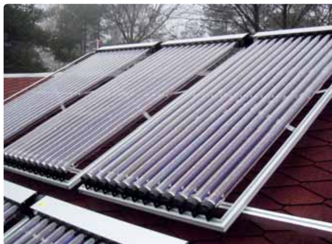
Abb.: Vakuumröhrenkollektoren VRK 12 als Aufdachmontage
