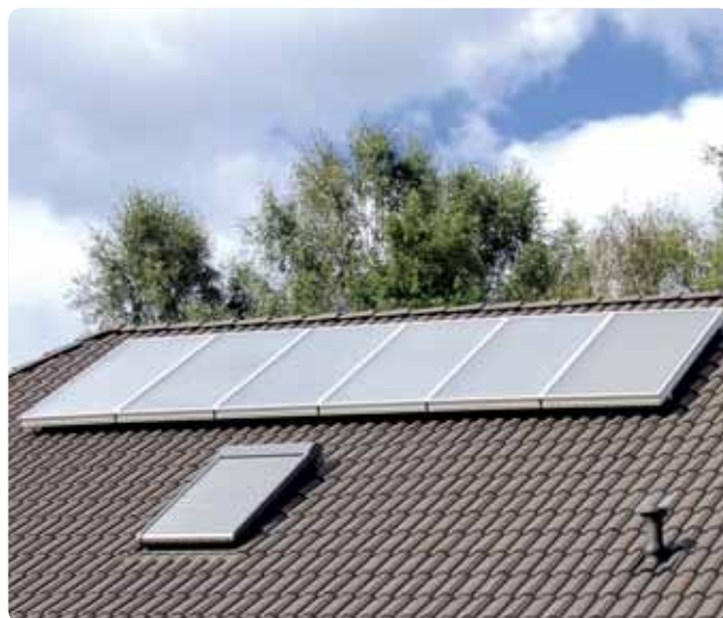
Thermische Solaraufsachanlage Einfamilienhaus in Finowfurt.
