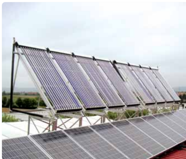
Kombinierte Photovoltaik (30 kWp)-Thermie-Flachdachanlage. Firmengebäude Kögel in Backnang.
