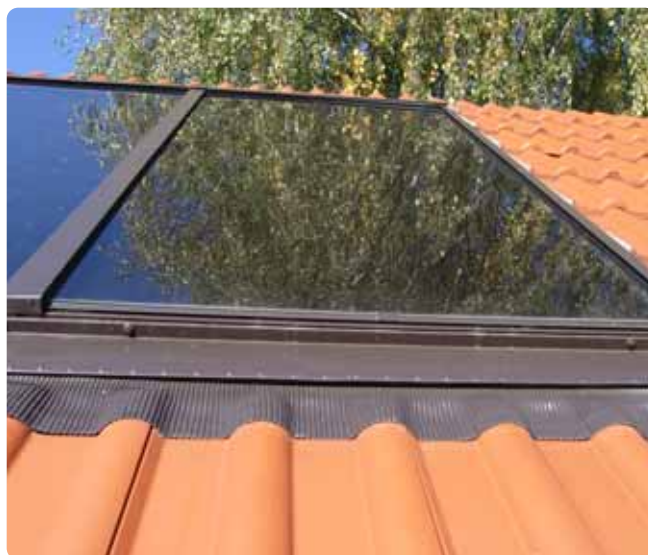
Kombinierte Photovoltaik-Thermie-Indachanlage. Musteranlage auf dem mp-tec Firmengelände in Eberswalde.
