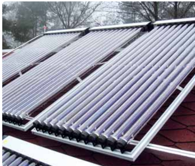
Thermische Solaraufdachanlage auf Campingplatz Amtsberg in Leipzig.
