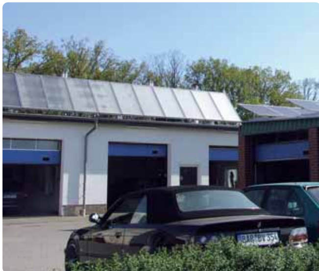
Kombinierte Photovoltaik (4,59 kWp)-Thermie-Flachdachanlage. Firmengebäude des KFZ-Service Walter in Golzow.
